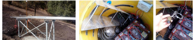
Fig. 5. Vandalismo en estación Los Maitenes (MT17)
